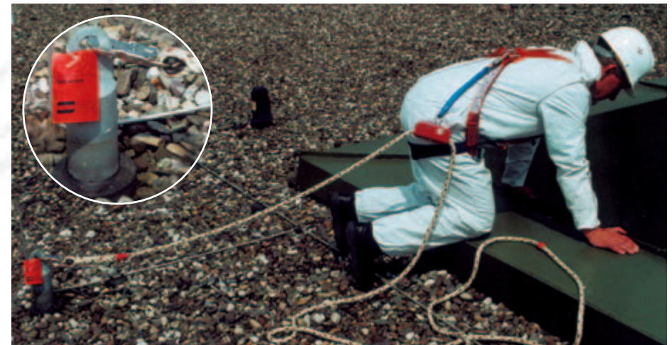
Bild 2-14: Anschlagpunkt auf einem Flachdach
